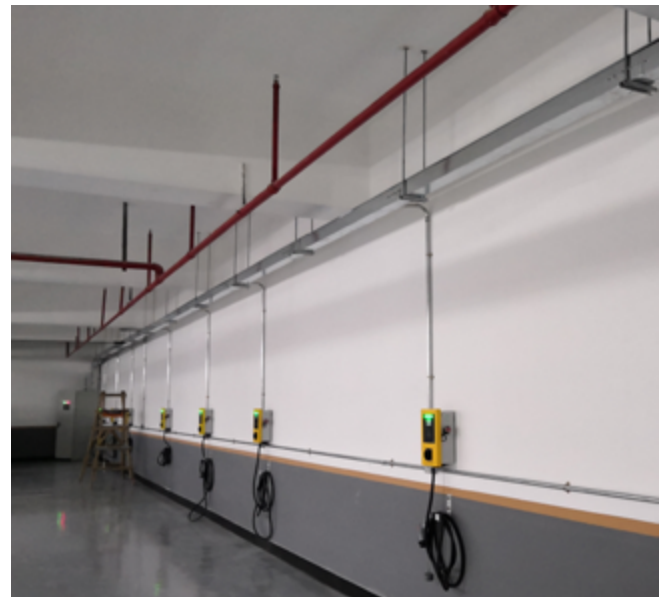
图 2：深圳国银民生金融大厦地下充电场站样板点
